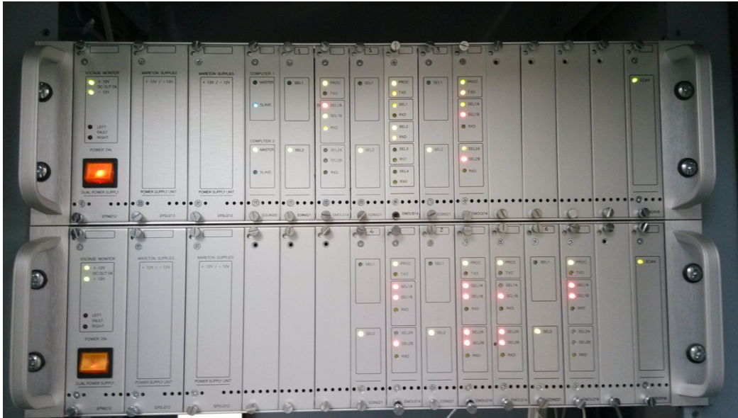
Napajanje sustava ECOM 12 je modularnim pretvaračima proizvođača MARETON.
